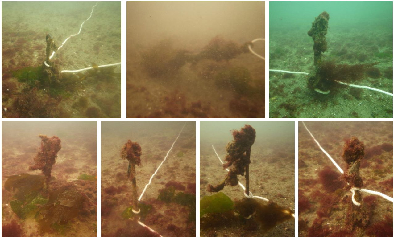
写真-4.3.12 残存していた7本の鉄筋杭(上左からNO.4、NO.7、NO.8、上左からNO.11、NO.12、NO.13、NO.14)
